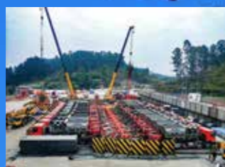
压裂增产技术
